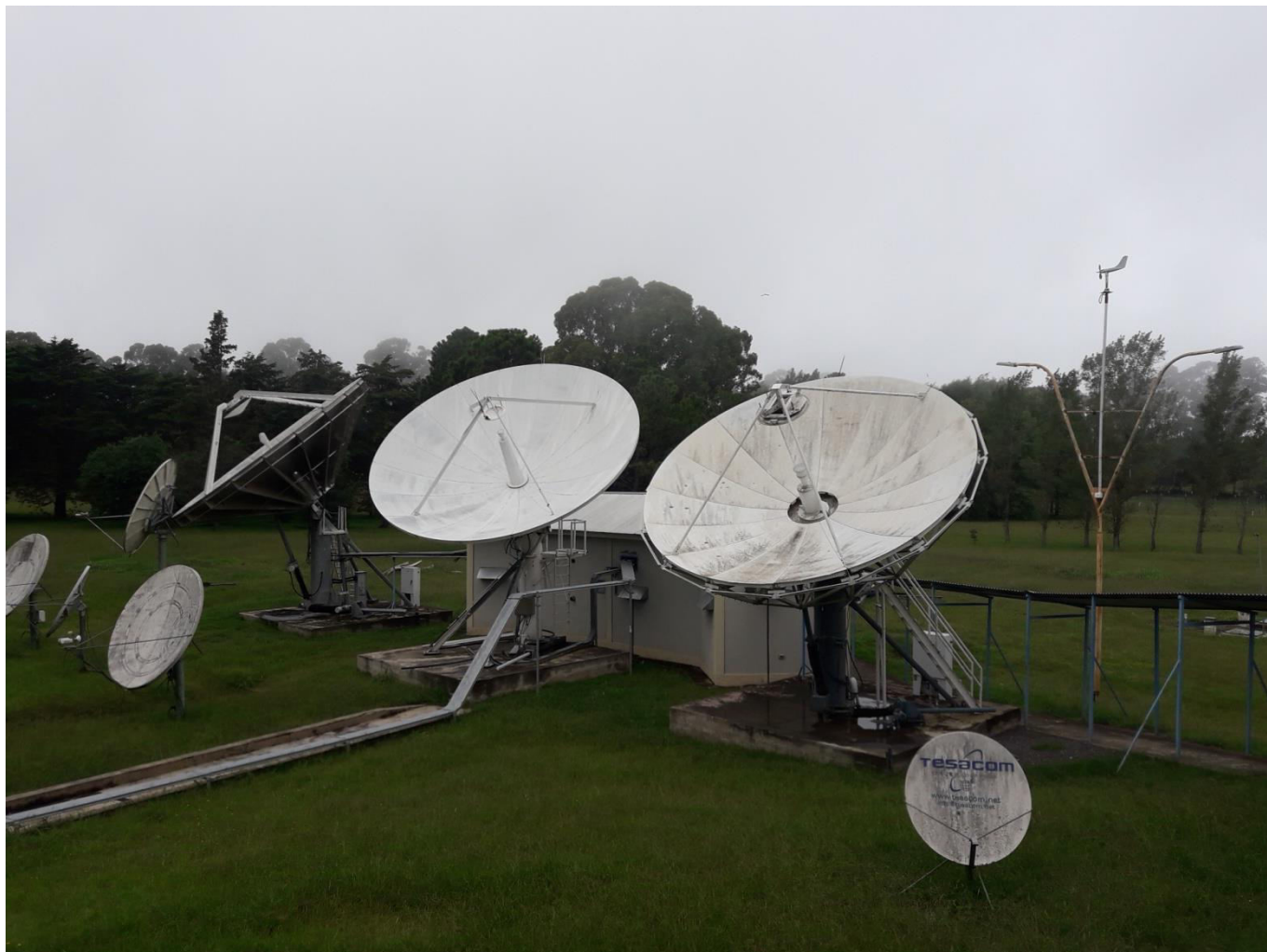
Parque de antenas
