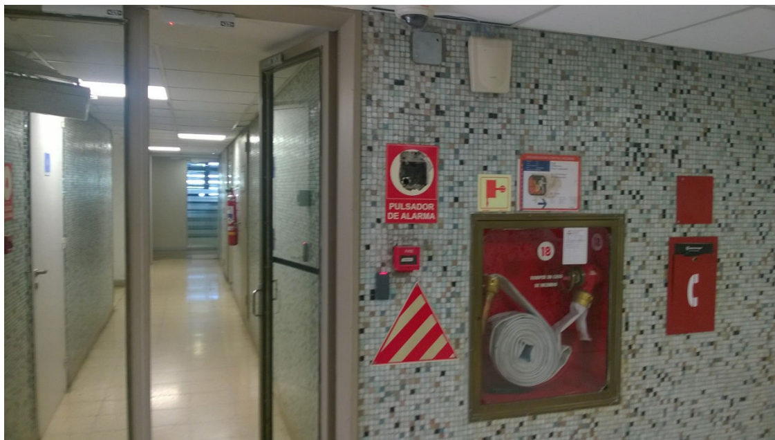
Nicho hidrante piso 2
