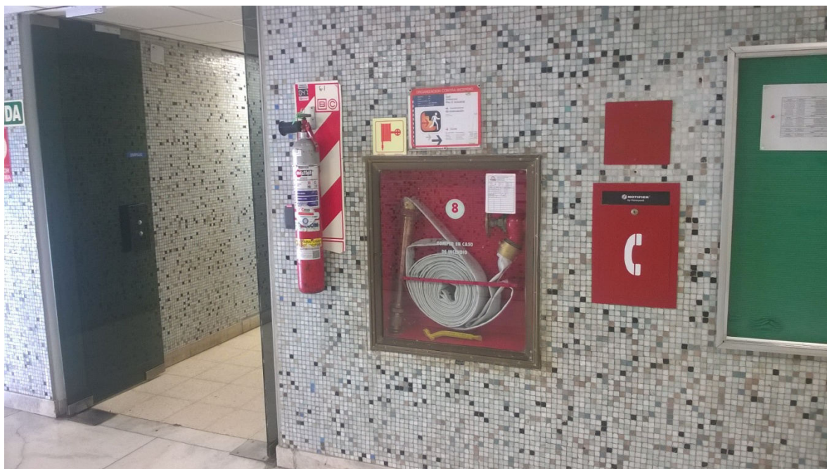
Nicho hidrante piso 6
