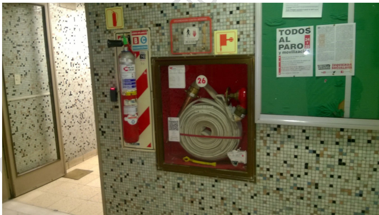
Nicho hidrante en planta baja
