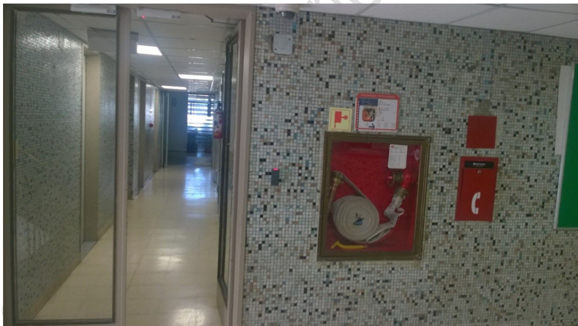
Nicho hidrante piso 3
