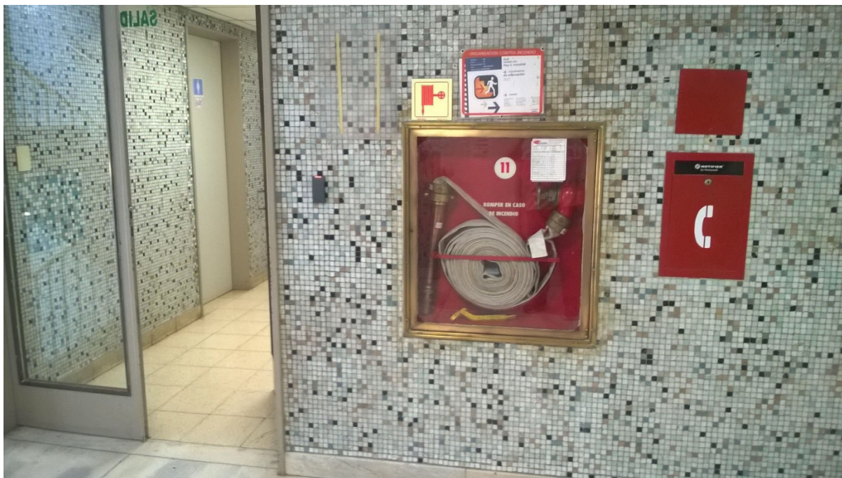
Nicho Hidrante piso 5
