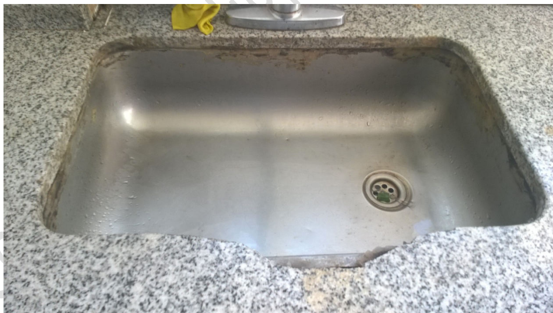
Sala de refrigerio piso 9 – Mesada rota
