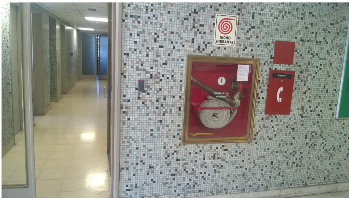
Nicho Hidrante evacuación piso 11
