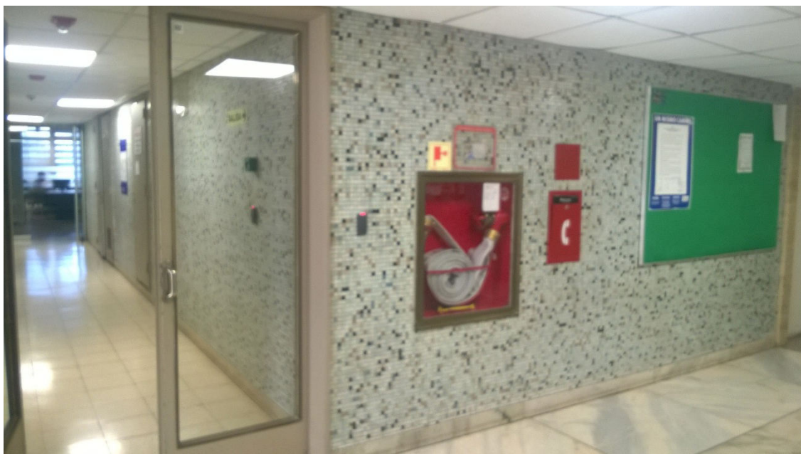
Nicho hidrante piso 1
