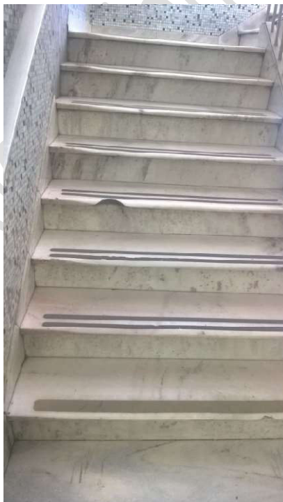
Escalon roto escalera principal (entre pisos 1 y 2)
