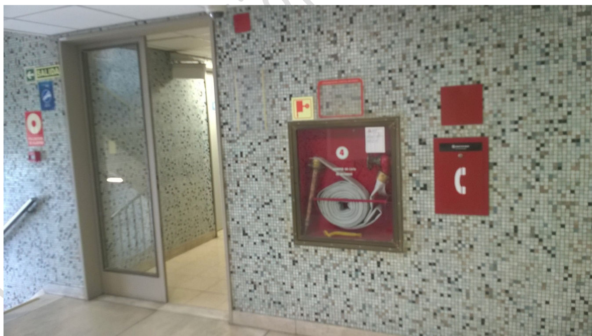
Nicho hidrante piso 8
