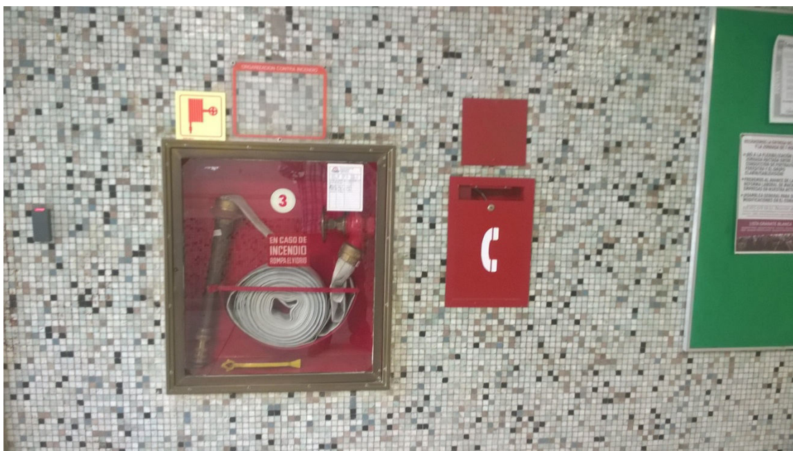
Nicho Hidrante piso 9
