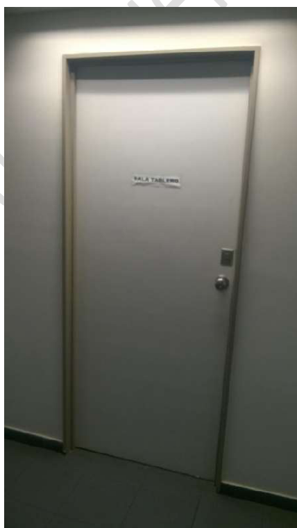
Sala tableros eléctricos piso 12
