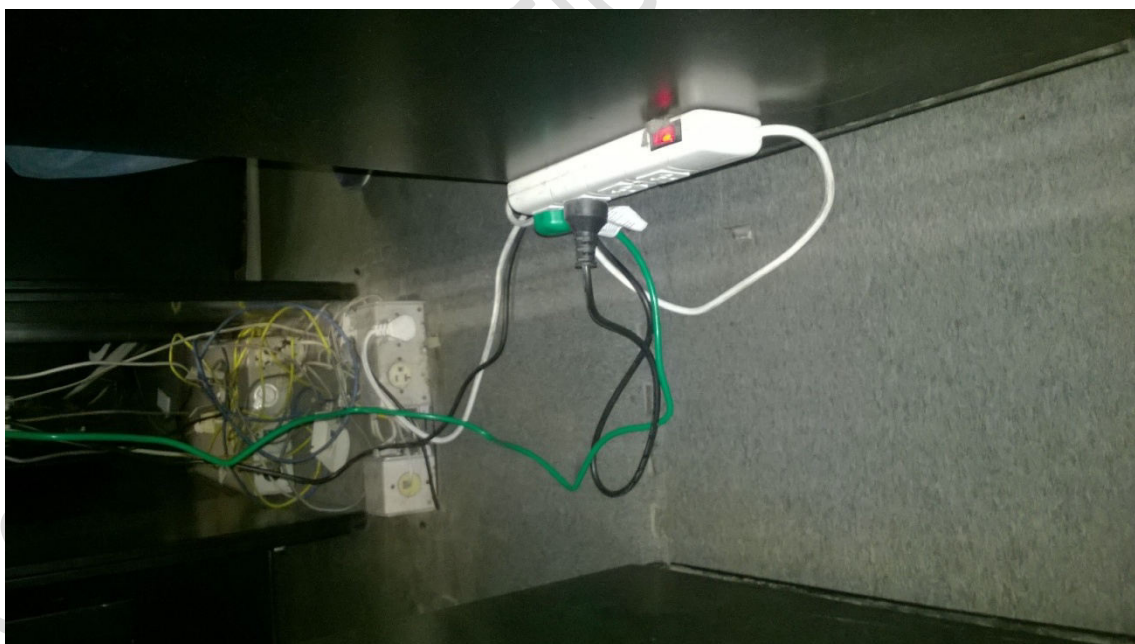
Instalación eléctrica precaria - piso 9
