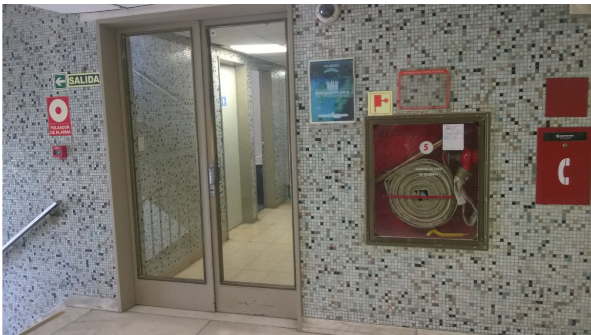
Nicho hidrante piso 7
