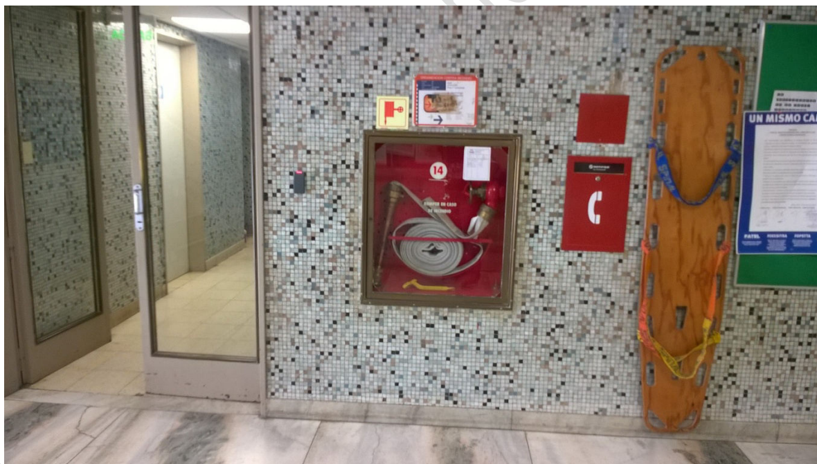
Nicho hidrante y tabla de auxilio piso 4
