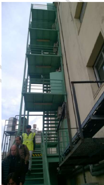
Escalera de emergencia externa (pisos 8 al 12)
