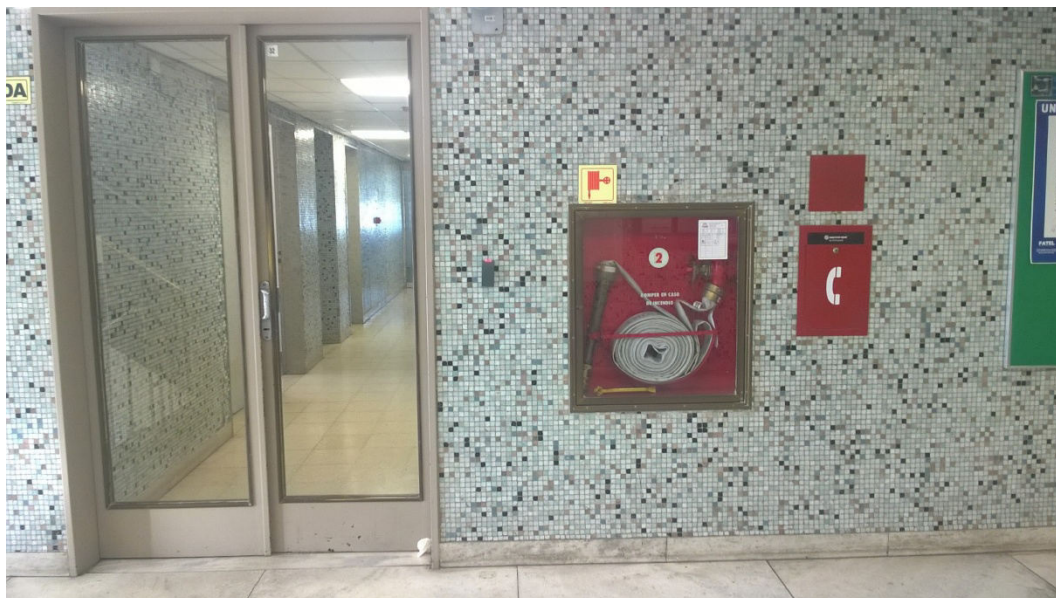
Nicho Hidrante piso 10
