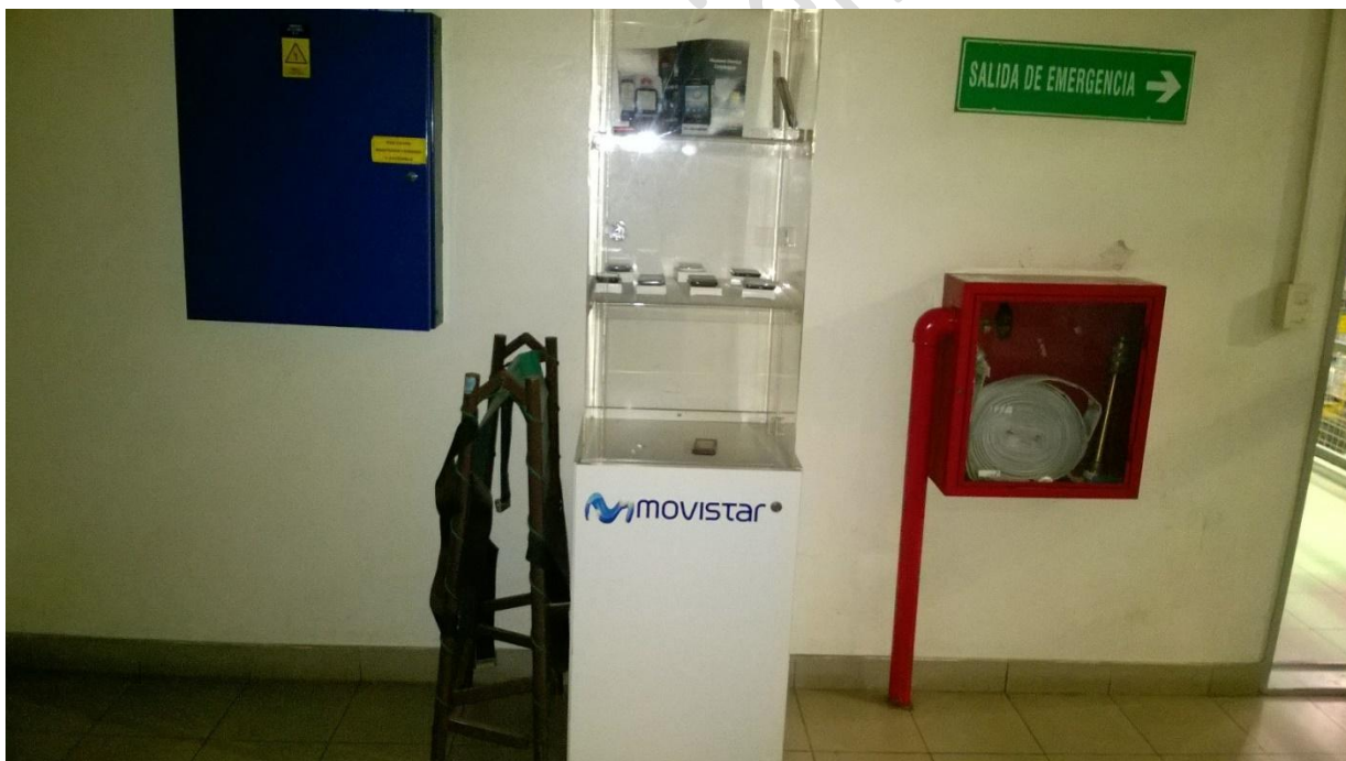
Acceso al Laboratorio de Calidad Nicho hidrante y camilla de auxilio
