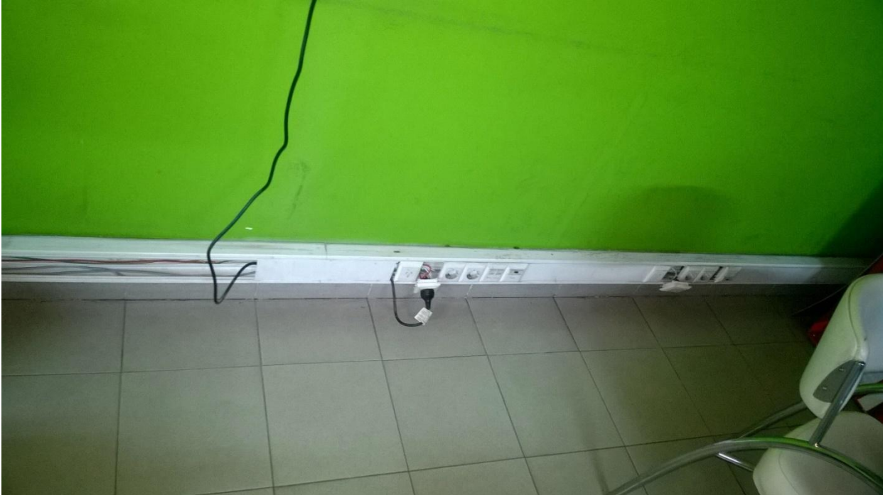
Comedor – Instalación eléctrica en mal estado de mantenimiento y con riesgo eléctrico
