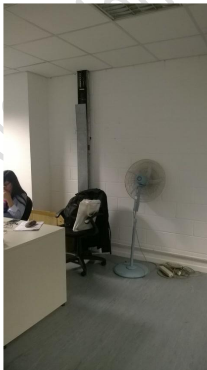
Sector Administración de Stock Canalización desprendida y con riesgo de caída sobre el personal
