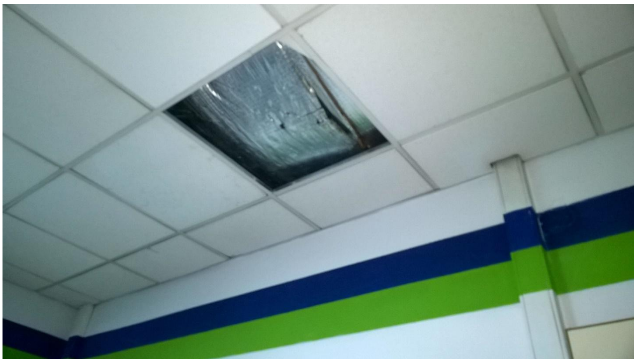
Comedor – Techo en mal estado de mantenimiento y con goteras
