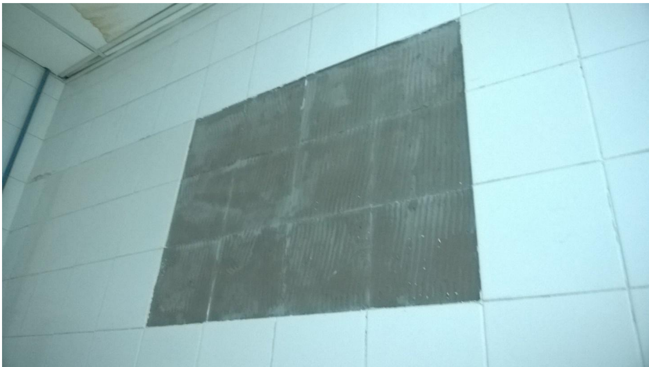
Baños masculinos – Falta de cerámicos en la pared
