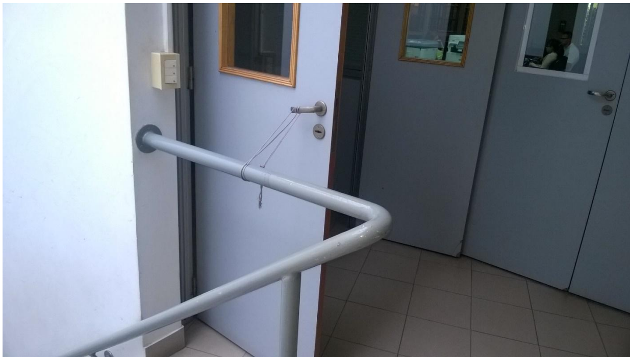
Puerta en condiciones incorrectas de apertura
