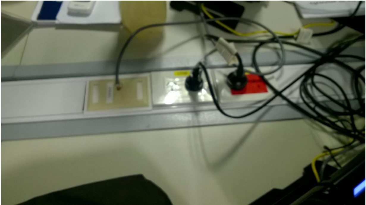
Sector Administración de Stock Toma de energía y red de datos en los puestos de trabajo
