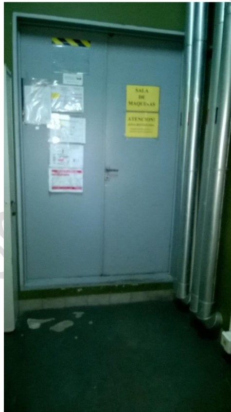
Sala de máquinas ubicada frente al gimnasio
