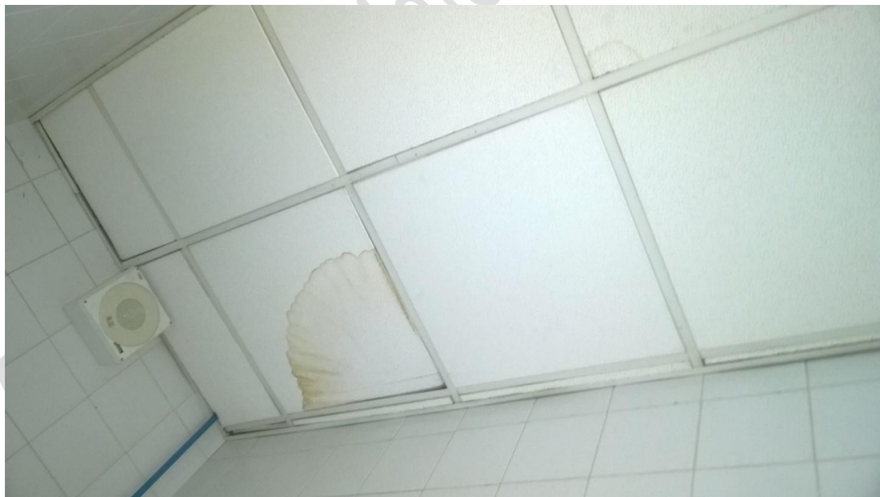
Baños masculinos – Manchas de humedad en el techo
