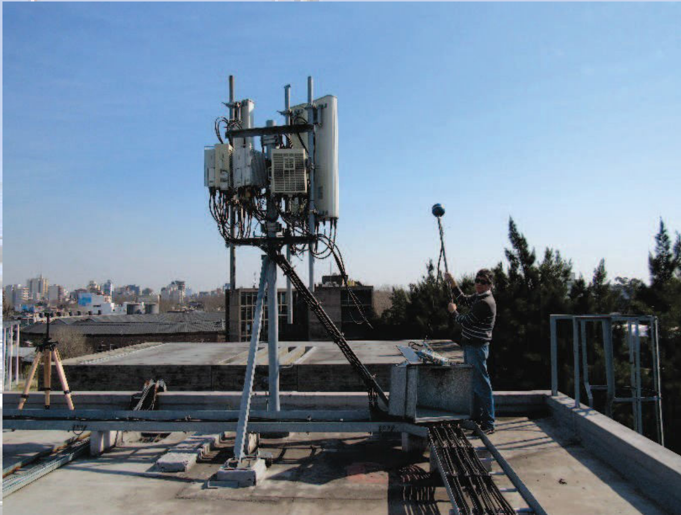
Medición RNI en el emplazamiento sector A
